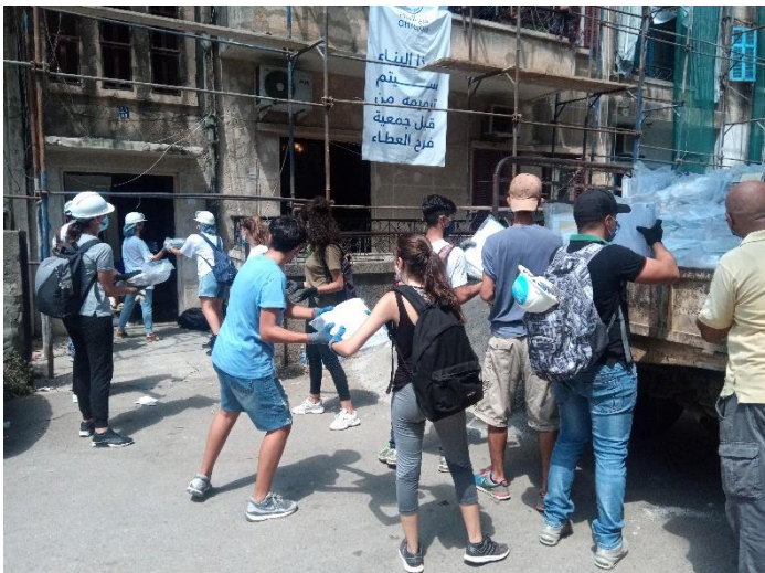
Dégagement des débris, Karantina, Aout 2020)
